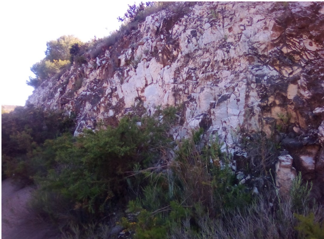
IMAGEN 1 Macizo rocoso calidad regular. Alteración superficial, orientación de las discontinuidades a favor de pendientes y diferentes juegos de fracturas
