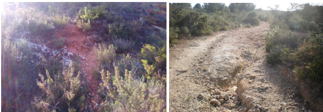
Procesos de inestabilidad existentes en taludes y en caminos de la zona de estudio
